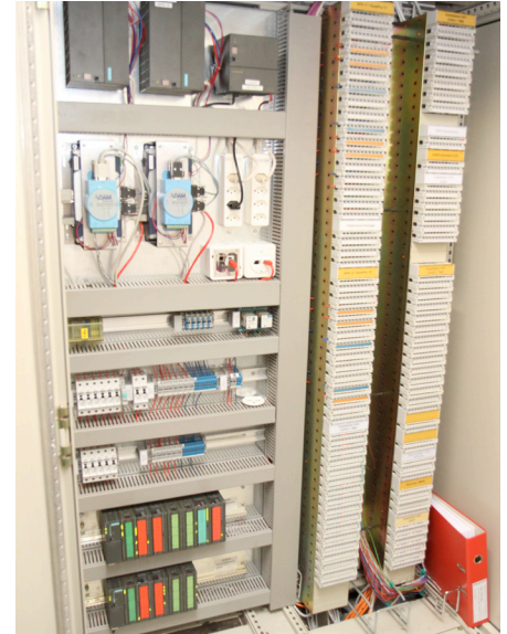
Selbst diese Zentrale der ersten Generation ist nach Jahren und mehreren Software-Upgrades noch in Betrieb.
